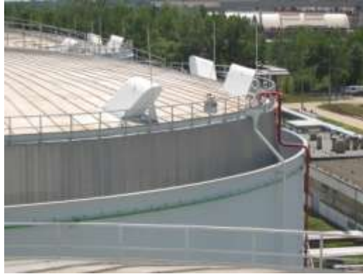
31. ábra: Védőgyűrűs, belső úszótetős tartály habbaloltó berendezéssel, palást-hűtővel és csapadékvíz elvezető szerelvényekkel(forrás: BM OKF)
