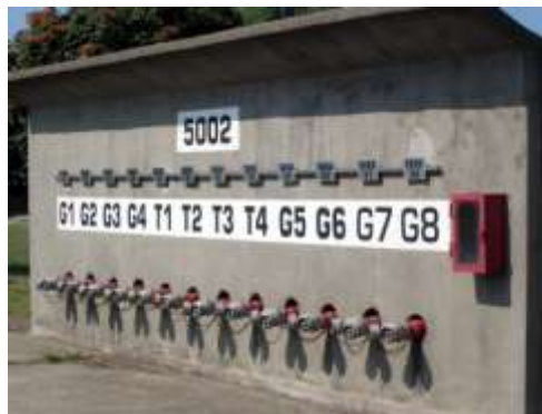
32. ábra: Tűzoltó mellvédfal a félstabil oltóberendezés csatlakozó csonkjaival (forrás: BM OKF)
