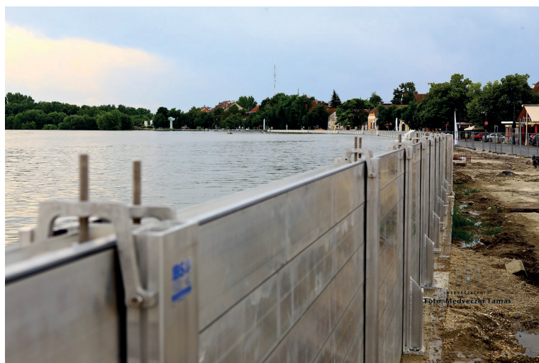
4. ábra. Szentendrén telepített mobil árvízvédelmi fal [19]
