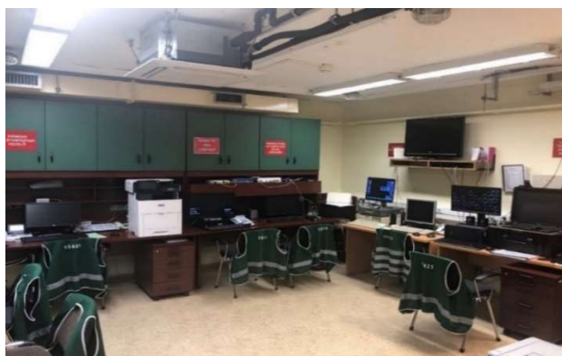
7. kép: Kommunikációért felelős berendezések helysége. Forrás: [saját]
