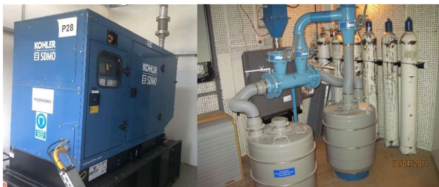
8. kép: Védett Vezetési Pont dízel generátora és hermetizálás esetén a levegőtisztító rendszere. Forrás: [saját]
