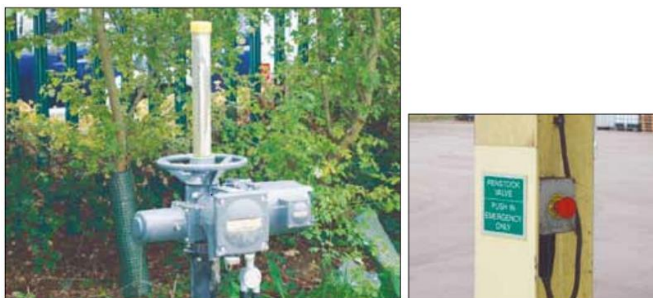
4. kép: Távirányítású csatornakivezető elzáró berendezés, üzemben belüli kézi indítással
