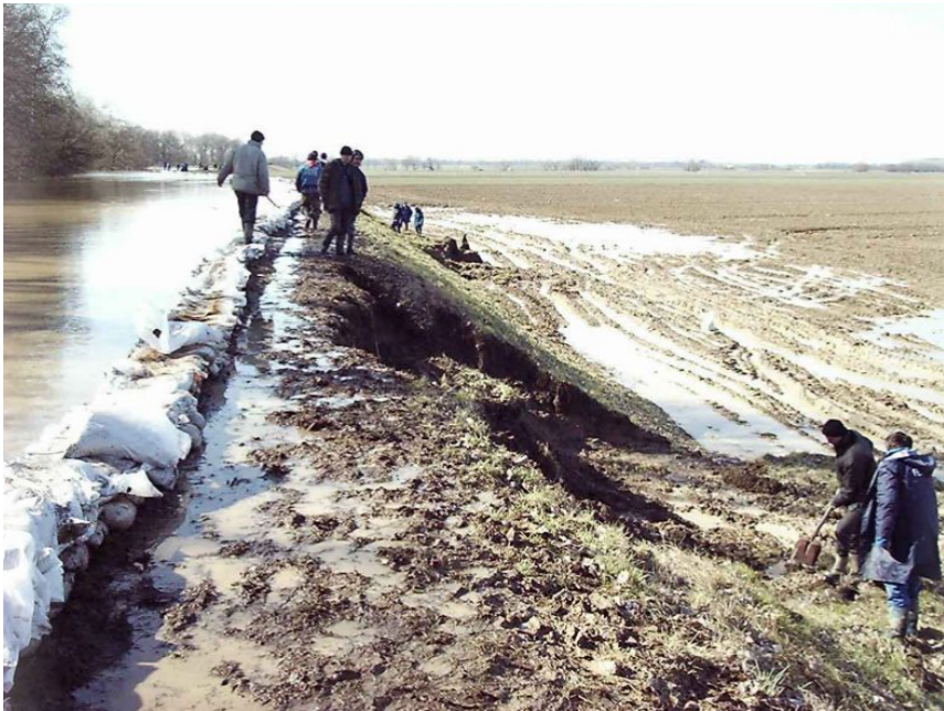
3. ábra: Tarpai rézsúcsúszás, 2001
