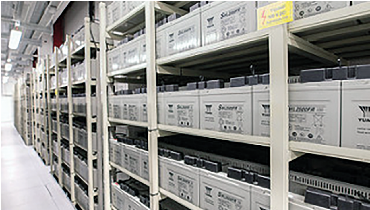
10. ábra „DC10” adatközpont-parkakkumulátor-telep Forrás: Invitech Solutions; Fotó: Noguchi Partners
