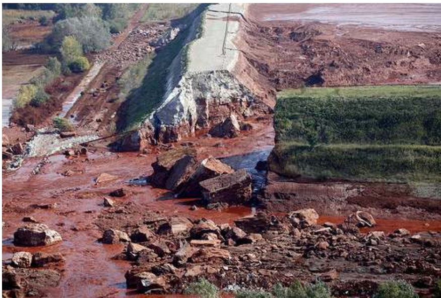
1. ábra: Az átszakadt gát [1]
