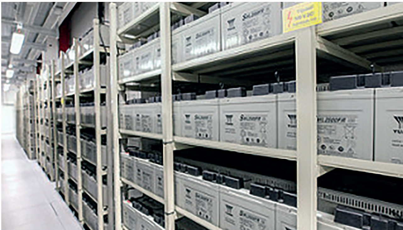
10. ábra „DC10” adatközpont-parkakkumulátor-telep
