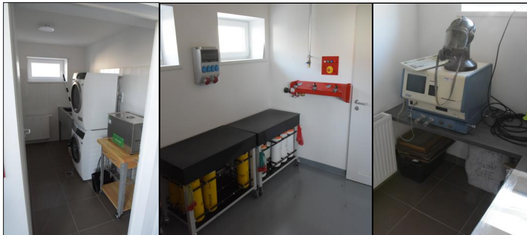
11. kép: Korszerű berendezések a laktanyában Készítette: a szerző
