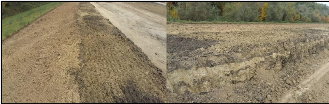
23. sz. ábra: Az óballai Tisza bal parti szakaszon végzett töltéselbontási munkák során feltárt „hagymahéj-szerkezet” felülnézetben (balról) és oldalnézetben (jobbról) Készítette: a szerző
