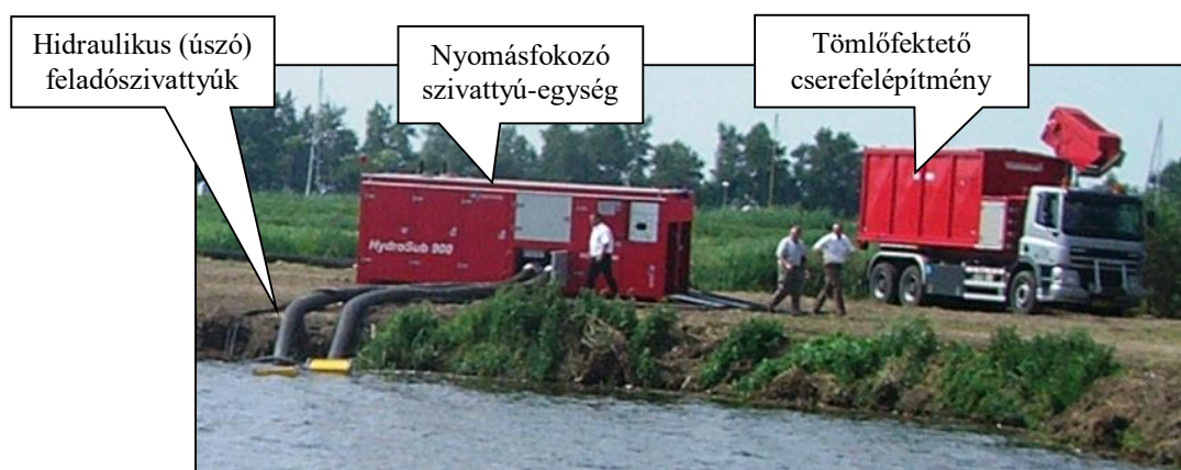
20. ábra: HFS nagyteljesítményű mobil tűzvíz ellátó rendszer
