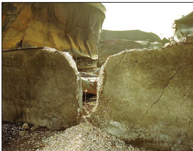
3. fénykép: Tűzeset során károsodott védőfal
