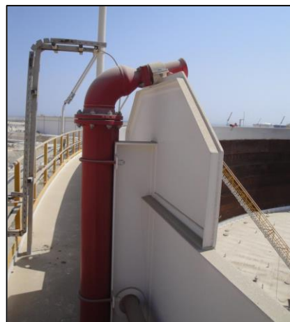
27. fénykép: Rögzített „hablövellő” ágyú beépítve [108]
