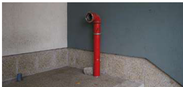
9. fénykép: Csatlakozási pont (forrás: FKI)
