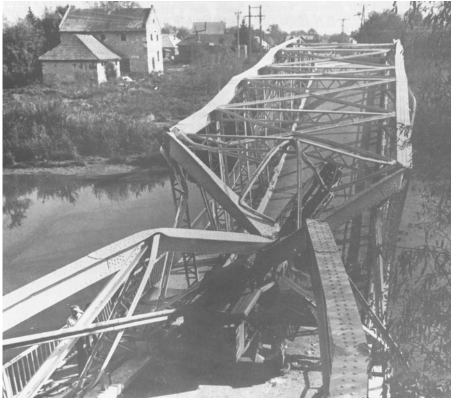
2-4 ábra Gesztelyi Hernád híd leszakadása 50
