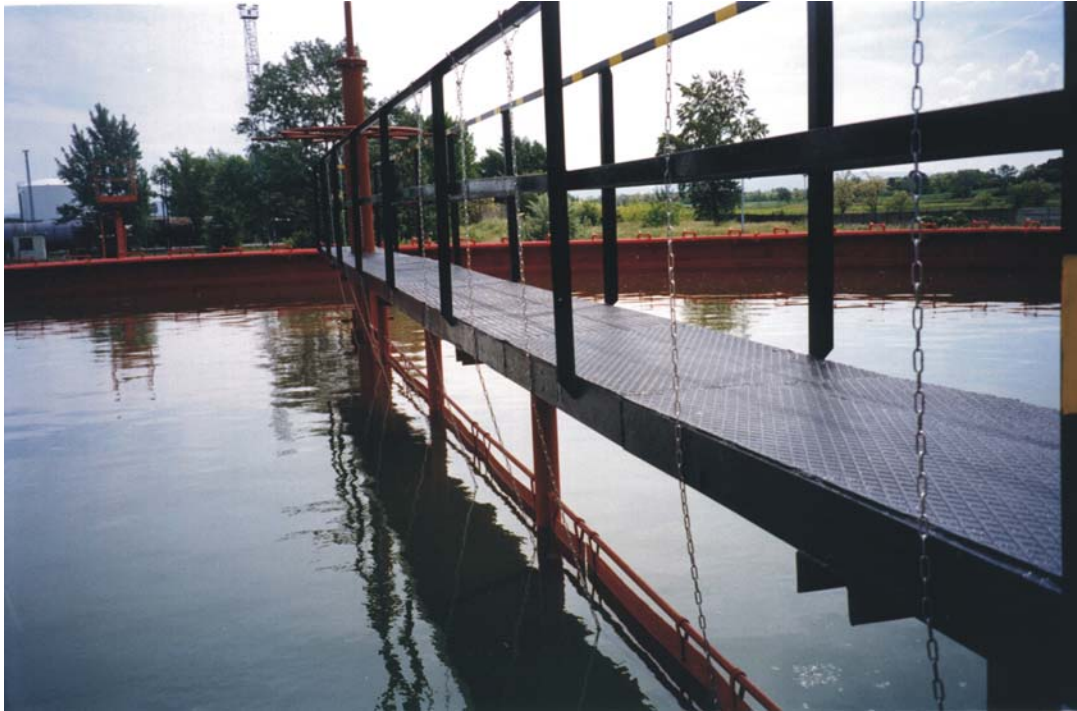
9. kép: Acélszerkezetű kezelőjárda a tartályba építve
