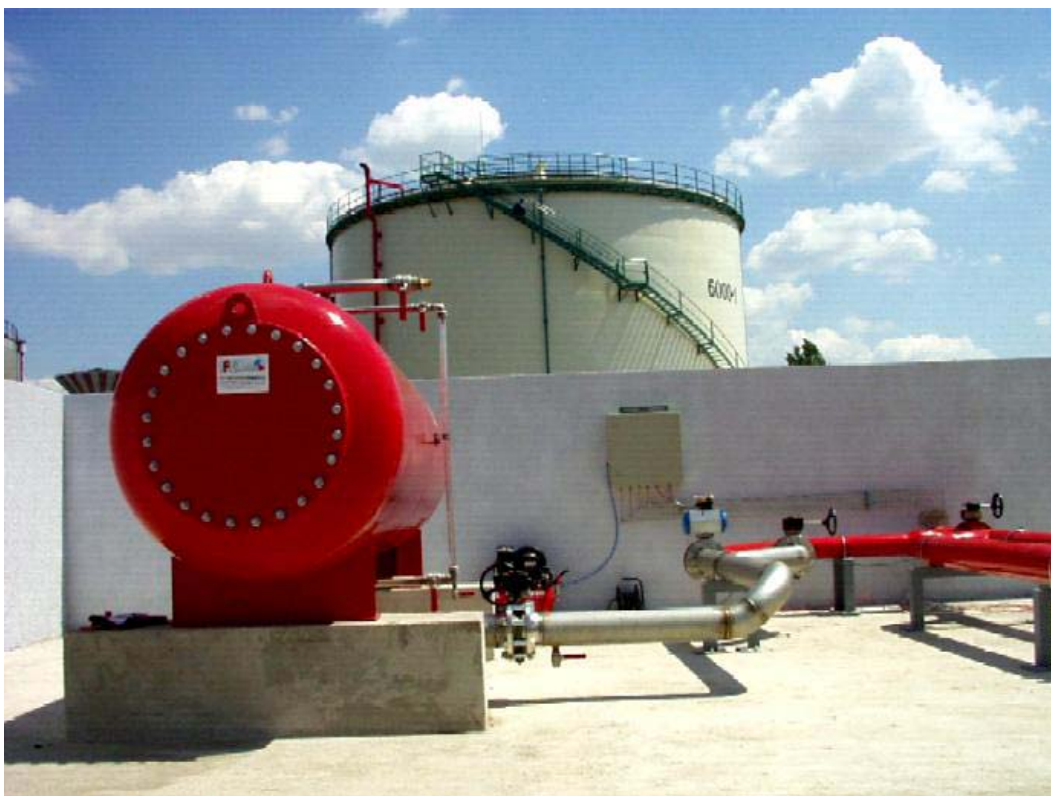
23. kép: A Kispesti Erőmű 6 000 m 3 -es tartályának automatikus oltóberendezése
