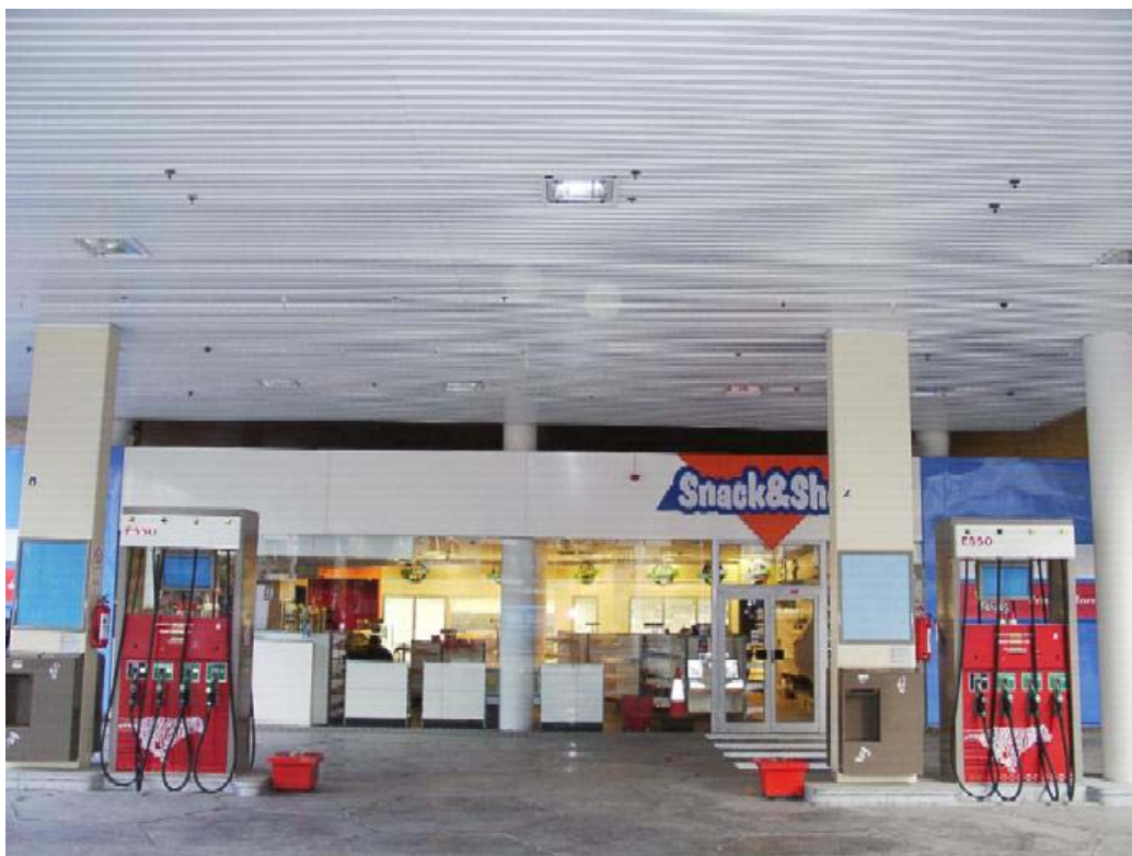
29. kép: Az Orczy téri benzinkút habelárasztó berendezése
