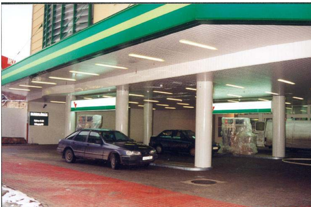
27. kép: A Futó utcai benzinkút habelárasztó berendezése
