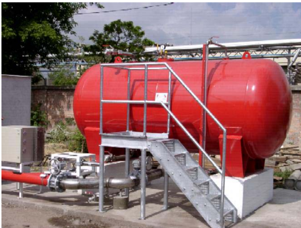
21. kép: Az Újpesti Erőmű oltóberendezésének automatikus szelepei és habtartálya
