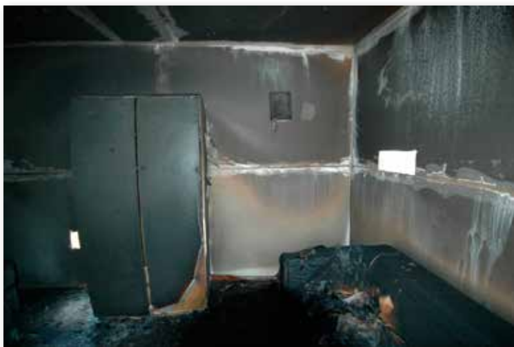
60. kép A szekrény jobb oldalán lényegesen gyengébb tűzzel érintettség látható, különösen alul. Az USA ATF tűzvizsgálóinak felvétele, ILEA oktatás keretében.
